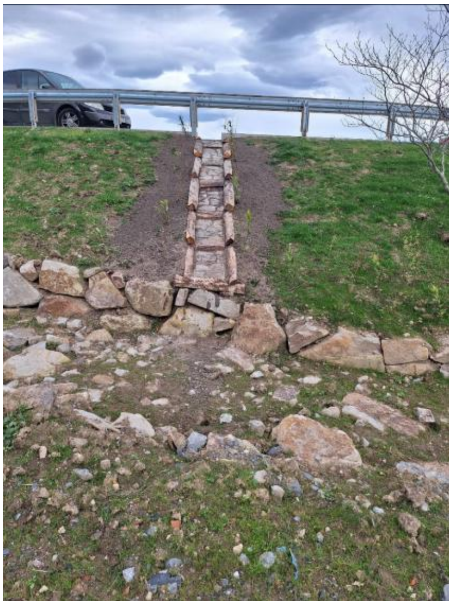
Bajante con técnicas de bioingeniería en talud este
